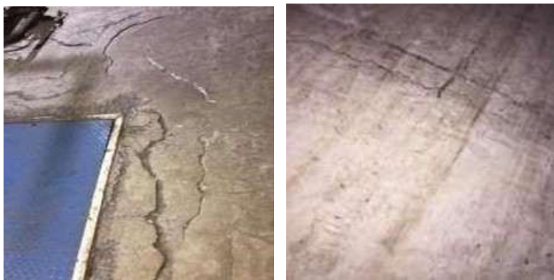
Gambar 2. Keretakan pada Pelat Lantai 2 dan 3 Bangunan
