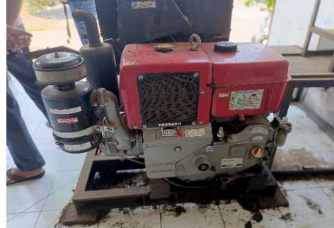
Gambar 6. Kerusakan mesin diesel penggerak
