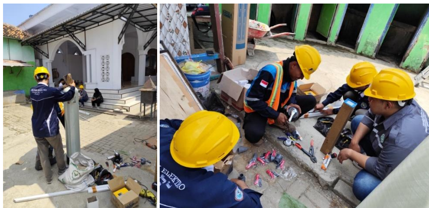
Gambar 4. Instalasi pompa dan tandon air.
