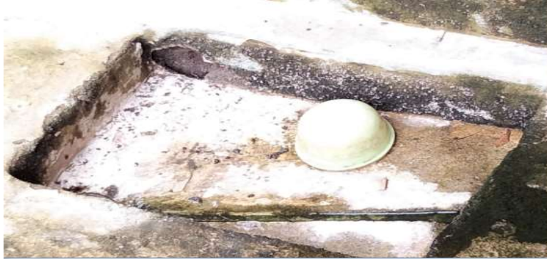
Gambar 3. Kebocoran Pada Kolam Ikan
